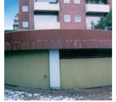
Isı gerilimi dolayısı ile çatlak oluşumu
