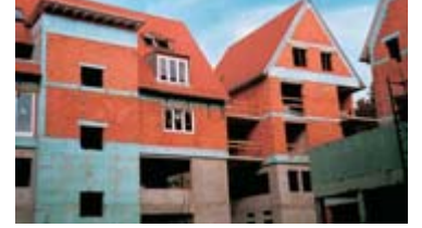
Isı köprüsü ve çatlak oluşum tehlikesi ile karışık duvar
